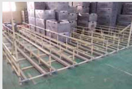
▲ 고로 컨베이어 (COLO CONVEYOR)
